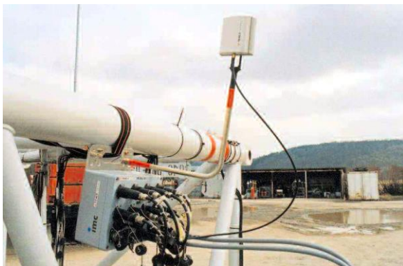
Abb. 4: Signalverarbeitungsgerät von imc mit WLAN-Antennen zur kabellosen Signalübertragung während der Montage an einem Gittermast-Ausleger.
