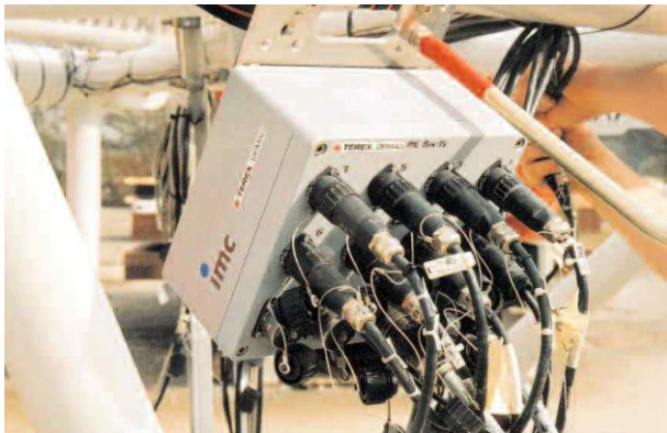
Abb. 3: In der Gitterstruktur des Auslegers befestigtes imc-Gerät für den Anschluss von acht DMS-Kanälen mit Antenne für die Datenübertragung per WLAN.
