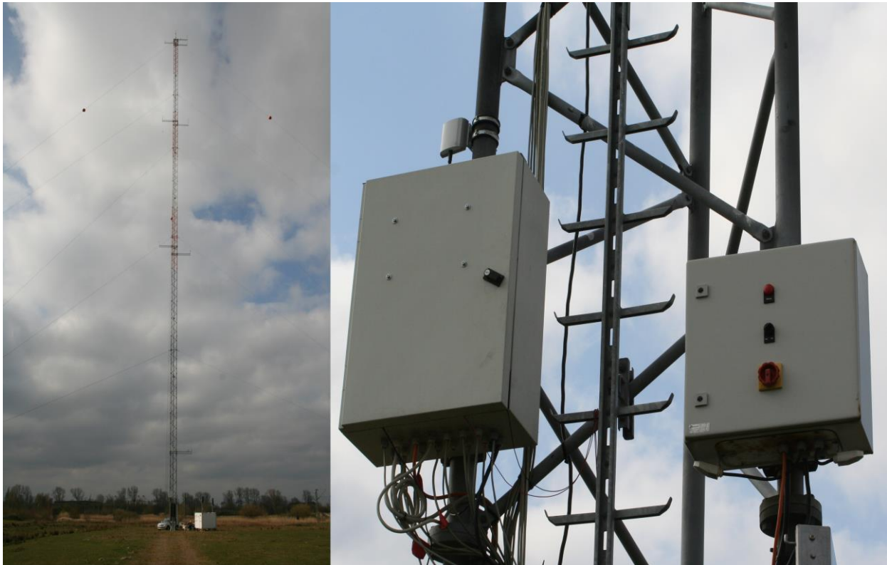
Abb. 3: Messmast/Schaltschrank mit angebrachter Richtfunkantenne
