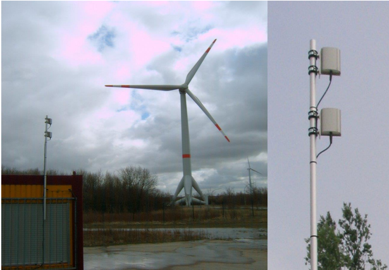
Abb.5: Richtfunkantennen mit Windenergieanlage im Hintergrund
